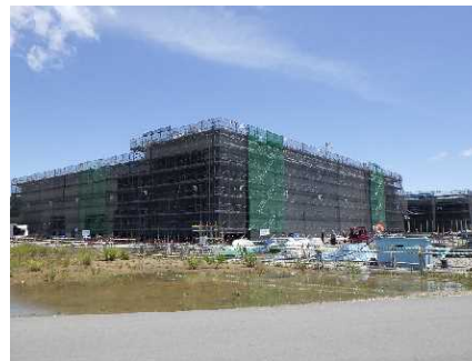
減容処理設備 (2023年竣工予定)
