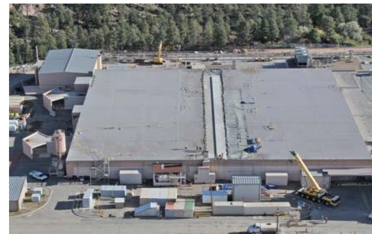
耐震性能のためのLANLのPF-4の新しいドラッグ・ストラット (drag strut)
