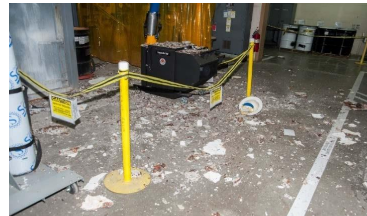
Y-12の9204-2建屋の天井落下の破片
